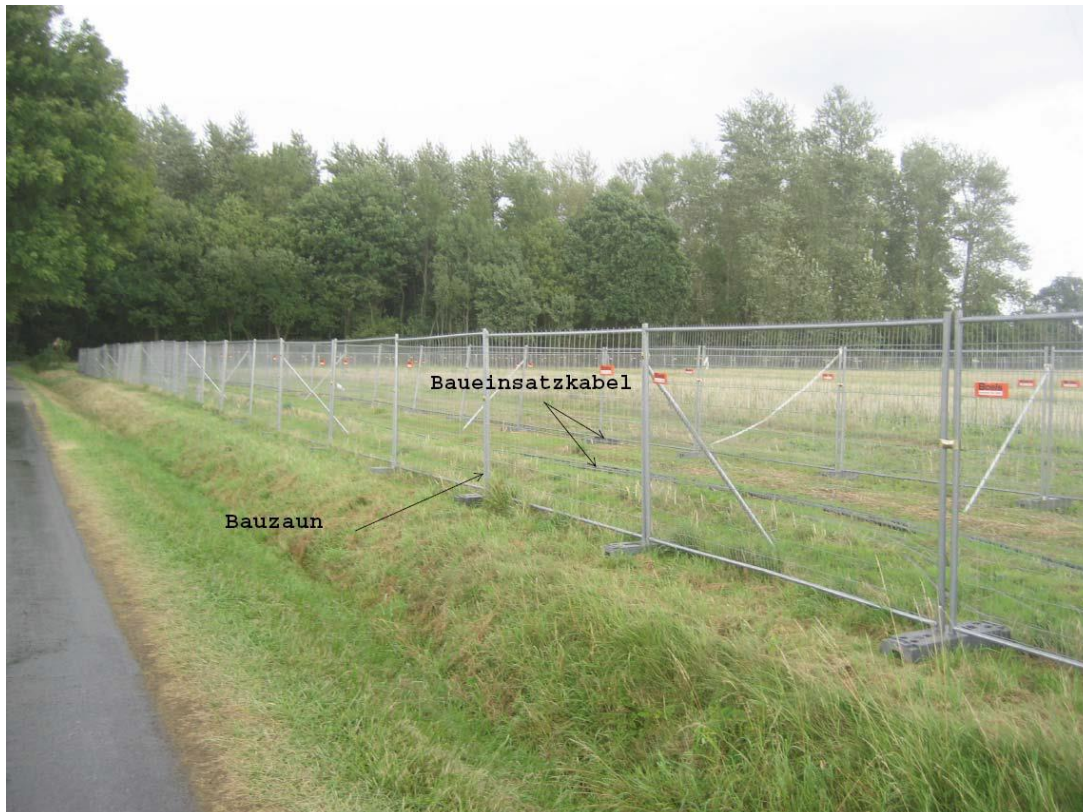
Abbildung 6: Baueinsatzkabel für 110-kV-Leitungen mit Sicherheitszaun (Quelle Amprion)
