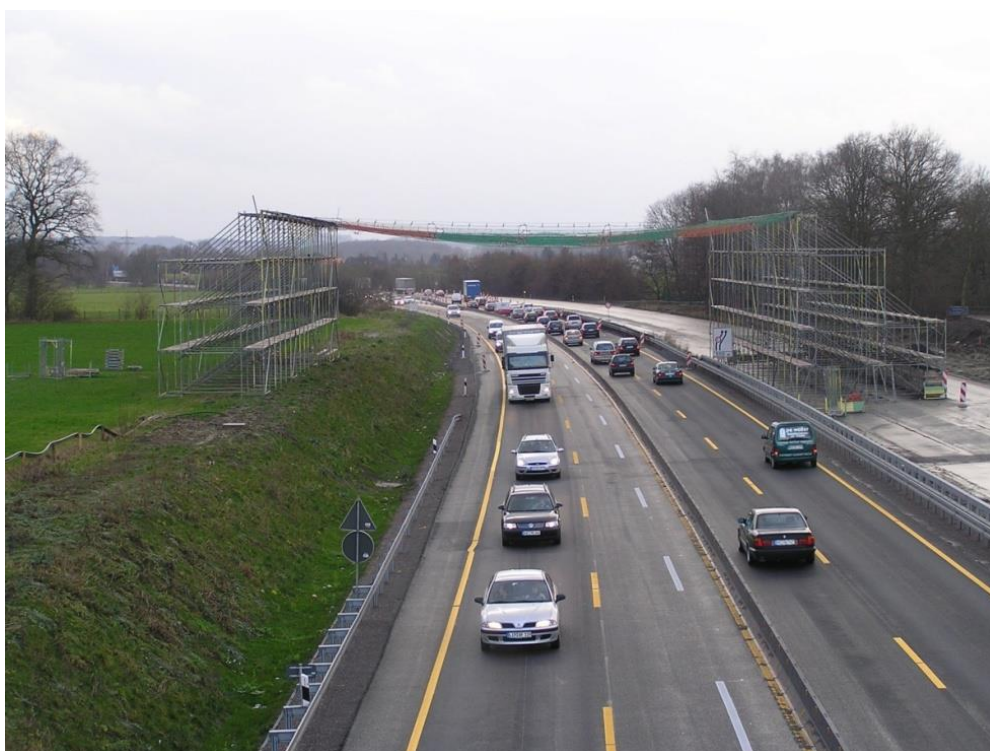
Abbildung 3-10 Stahlrohrschutzkonstruktion mit Netz über einer Autobahn (Quelle: Amprion GmbH)
